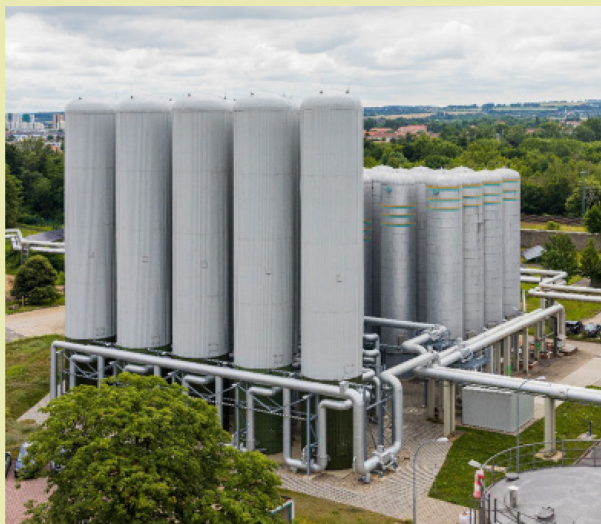
Šiluminės energijos saugykla Reick'o inovacijų elektrinėje; SachsenEnergie , Killig, 2021 m.
