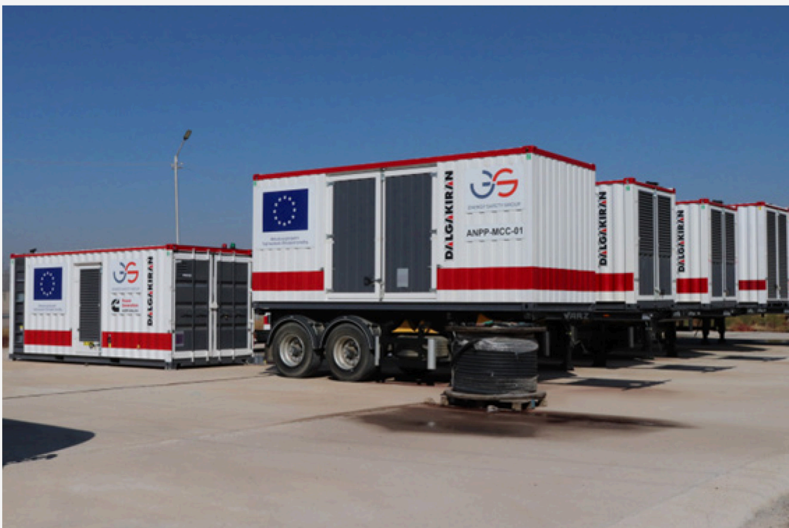
Fotografía 2: Equipos financiados por la UE: Generadores diésel móviles para la central nuclear armenia
