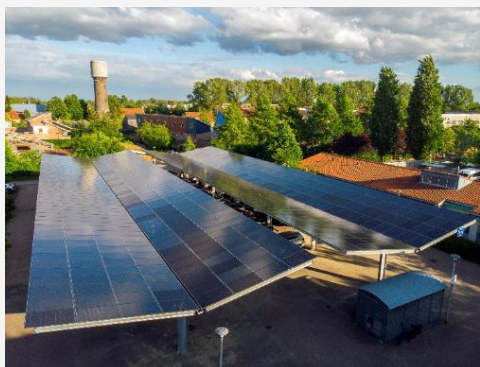
Solární park, který vyrábí elektřinu z obnovitelných zdrojů a nabíjí elektromobily (© Amar Sjaauw En Wa)
