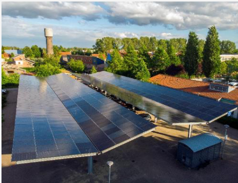
Marquesina solar para coches que genera electricidad renovable y sirve para cargar coches eléctricos (© Amar Sjauw En Wa)
