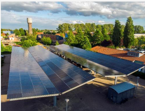
Päikesenergia töötab autode varjualune, mis toodab taastuvelektrit ja laadib elektriautosid (© Amar Sjauw En Wa)
