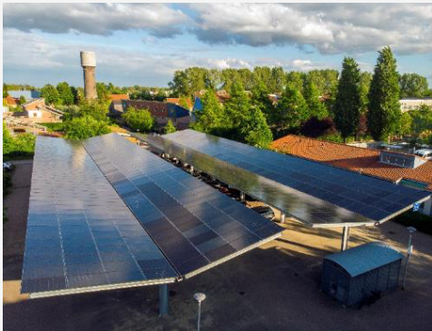
Aurinkosähköllä toimiva pysäköintialue, joka tuottaa uusiutuvaa sähköä ja lataa sähköautoja (© Amar Sjaauw En Wa)
