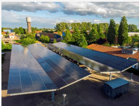
Parkiralište sa solarnim pločama koje proizvode električnu energiju iz obnovljivih izvora i omogućuju punjenje električnih automobila (© Amar Sjauw En Wa)
