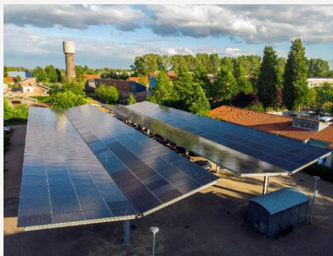
Megújuló energiaforrásokból villamos energiát előállító és elektromos autótöltő fedett szolár-autóbeálló (© Amar Sjawu En Wa)
