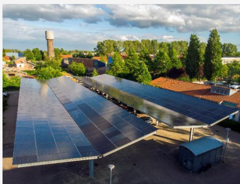
Pensilina fotovoltaica che genera energia elettrica da fonti rinnovabili e ricarica auto elettriche (© Amar Sjaauw En Wa)
