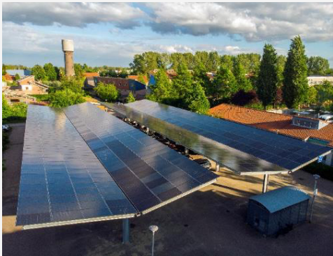
Saulės energijos automobilių stoginė, naudojama atsinaujinančiųjų išteklių elektros energijai gaminti ir elektromobiliams įkrauti (© Amar Sjauw En Wa)
