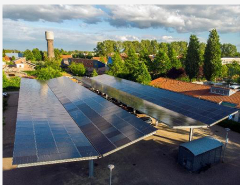
Copertină fotovoltaică pentru parcare, care produce energie electrică din surse regenerabile și este utilizată pentru încărcarea vehiculelor electrice (© Amar Sjauw En Wa)
