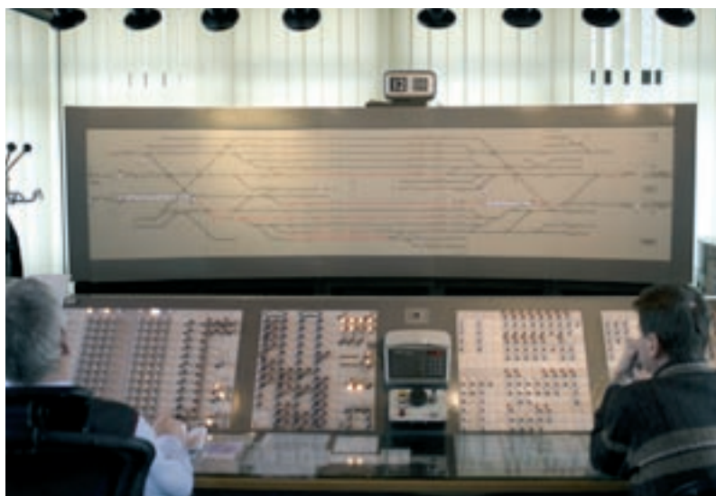
Fotografía 7. Instalaciones para el control del tráfico en la estación de Brennersee.
