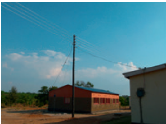
Udvidelse af elnet til bl.a. Kamilamboklinikken - projektet »Rural electrification infrastructure and small-scale projects« (Mumbwadistriktet, Zambia).
