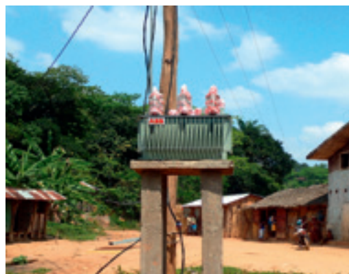
Anschluss eines Niederspannungstransformators an das Verteilernetz im Dorf Sahasinaka, Projekt rHYviere (Provinz Fianarantsoa, Madagaskar)
