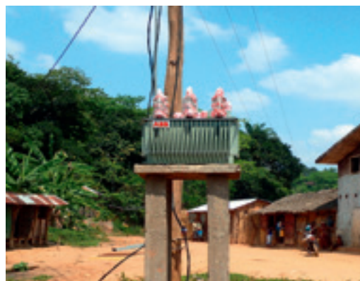
Μετασηματιστής χαμηλής τάσης συνδέεται στο δίκτυο διανομής στο χωριό Sahasinaka, έργο «rHYviere» (επαρχία Fianarantsoa, Μαδαγασκάρη).
