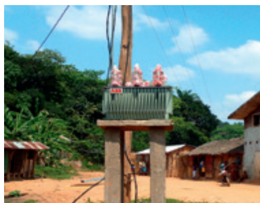
Trasformatore a bassa tensione collegato alla rete di distribuzione nel villaggio di Sahasinaka, progetto rHYviere, nella provincia di Fianarantsoa, Madagascar
