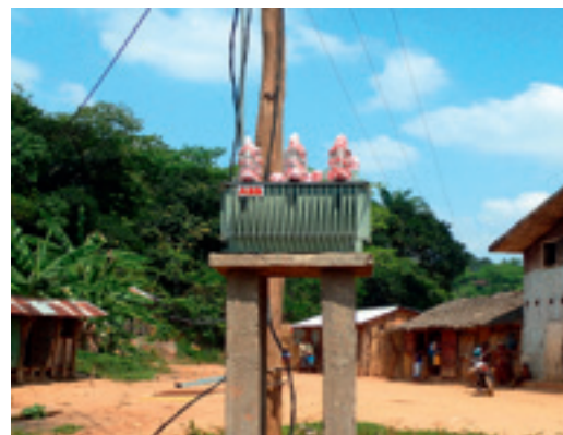
Žemos įtampos transformatorius sujungtas su paskirtymo tinklu Sahasinakos kaime, rHYviere projektas (Fianarantsoa provincija, Madagaskaras)
