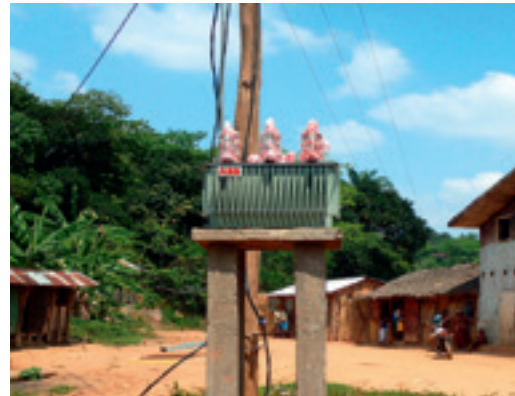
Povezovanje niskonapetostnega transformatorja na distribucijsko omrežje v vasi Sahasinaka, projekt rHYvière (pokrajina Fianarantsoa, Madagaskar)
