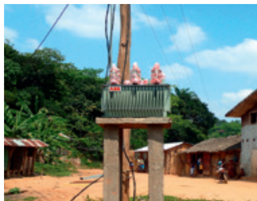
En lågspänningstransformator kopplas till distributionsnätet i byn Sahasinaka, projektet rHYviere (provinen Fianarantsoa, Madagaskar).
