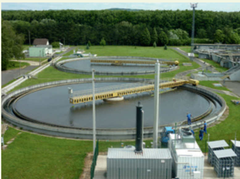
Fotografía 1. Instalación de tratamiento de aguas residuales en Hungría
