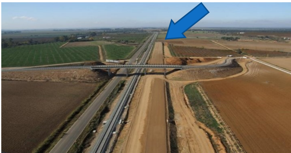
Fotografia 1 – Chýbajúci úsek na hraničnom priechode na vysokorýchlostnej trati Madrid – Lisabon
