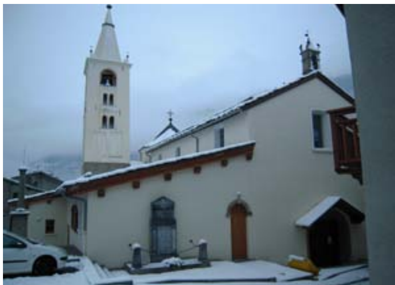
Fotografía 10. Proyecto consistente en la renovación de los muros exteriores y el tejado de una iglesia (Francia)
