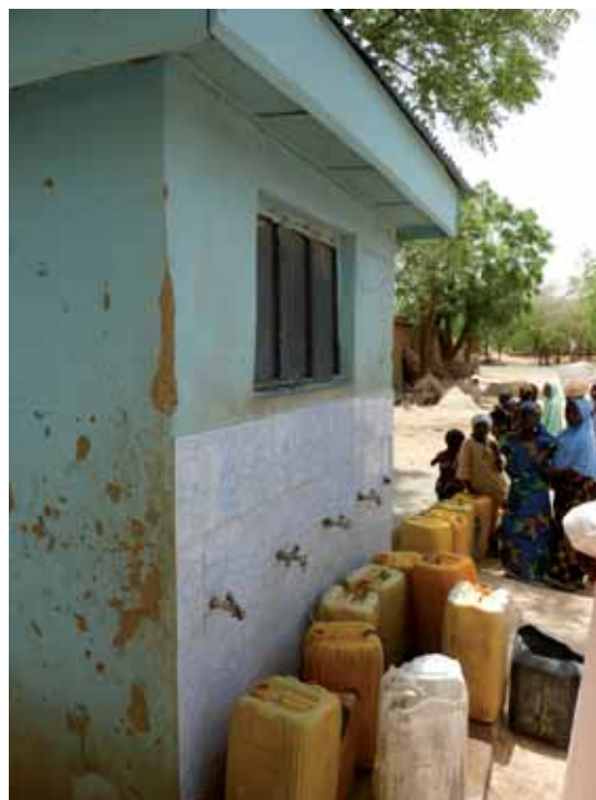
Posto de abastecimento de água, Jigawa, Nigéria
