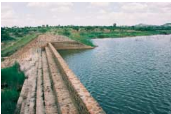
Una presa: numerosos beneficiarios indirectos
