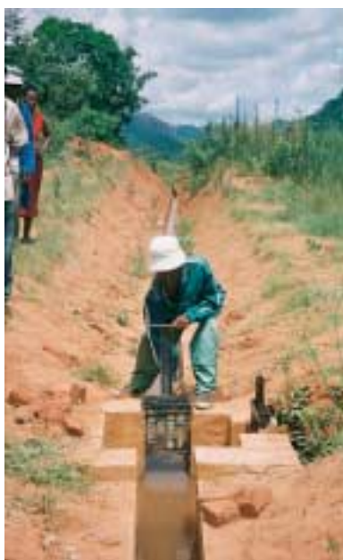
Necessità di curare la manutenzione dei sistemi di irrigazione
