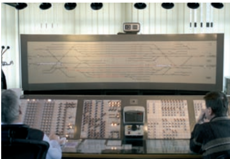
Φωτογραφία 7 – Εγκατάσταση ελέγχου της κυκλοφορίας στον σταθμό Brennersee
