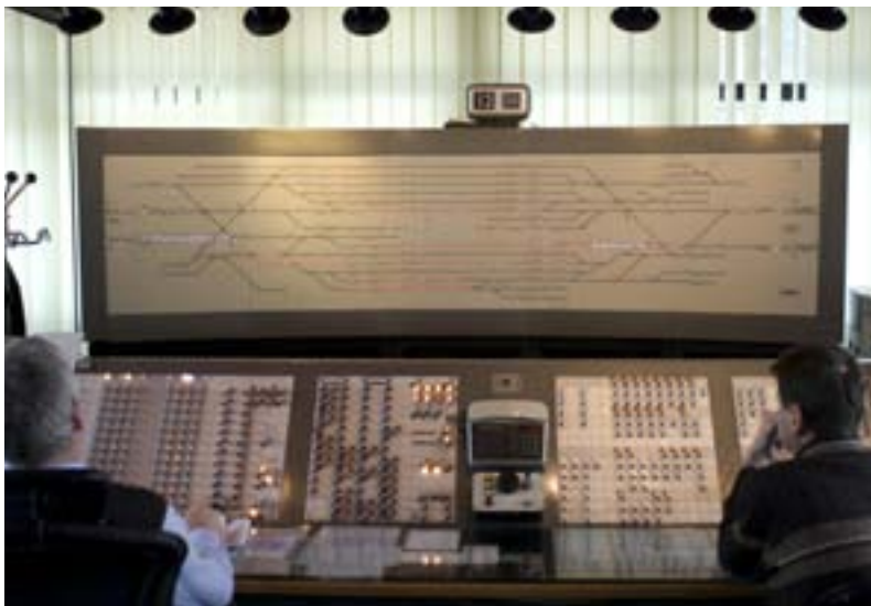
Kuva 7 – Liikenteenohjauslaitteisto Brennerseen asemalla
