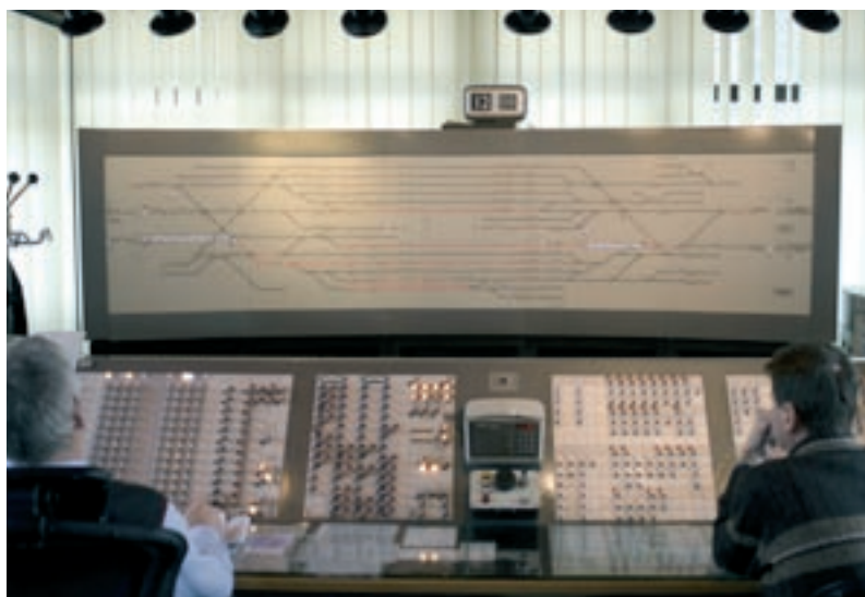
Fotografia 7 – Instalație de control al traficului la gara Brennersee
