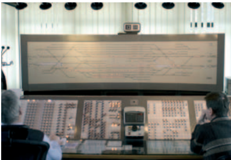
Fotografia 7 – Zariadenie na riadenie dopravy na stanici pri Brennersee
