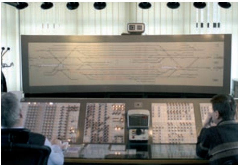
Fotografija 7 – Objekt za nadzor prometa na postaji Brennersee
