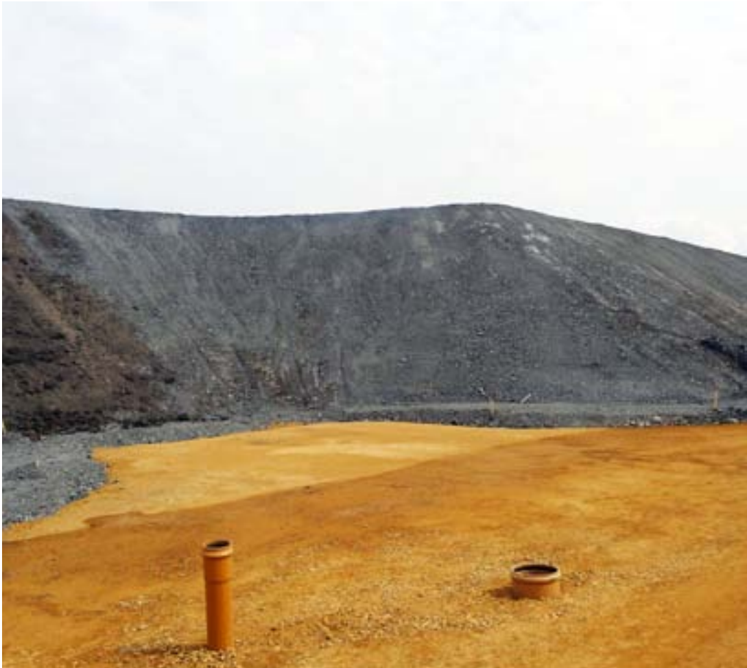
10. fénykép. Közúti infrastruktúra építéséhez előkészített munkaterület egy korábbi szénbánya meddőhányóinak helyén (Jaworzno, Lengyelország)
