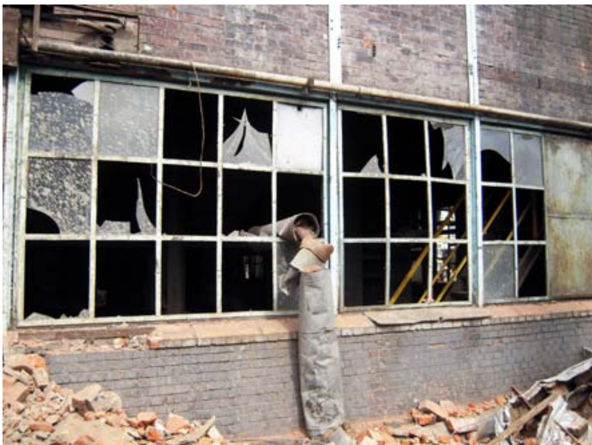
Foto 8 – Gamla byggnader rivs och renoveras vid ett övergivet kraftverk som håller på att omvandlas till ett konst- och kulturcentrum (Łódź i Polen).
